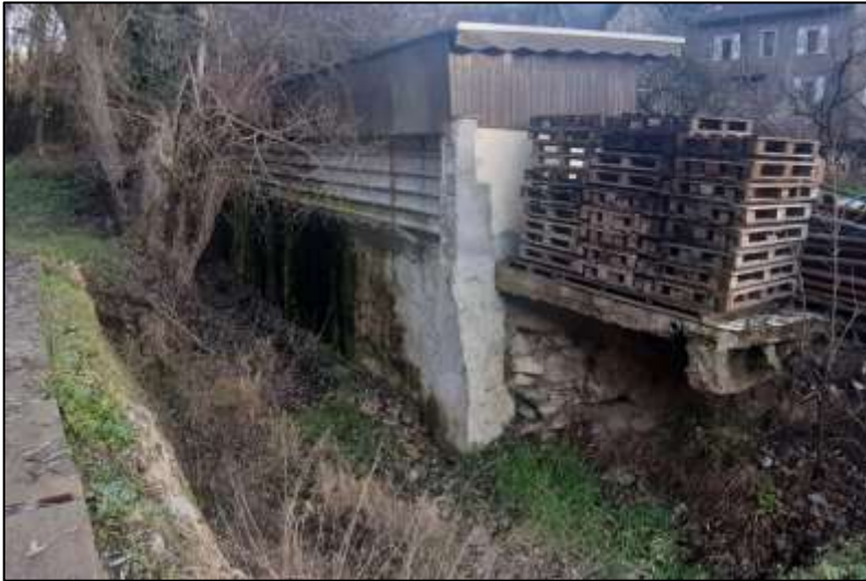
Erodiertes Fundament „schwebt“ über dem Gewässer, bald wird das Gewässer vom herabfallenden Bauschutt verschüttet.
