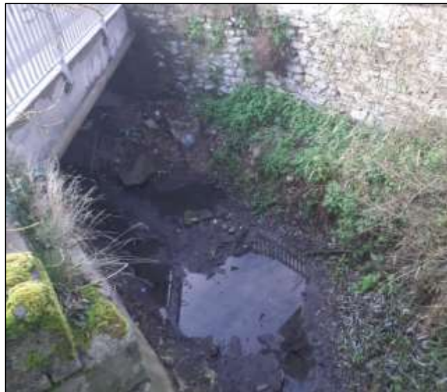
Sohlerosion an der Brücke in der Römerstraße
